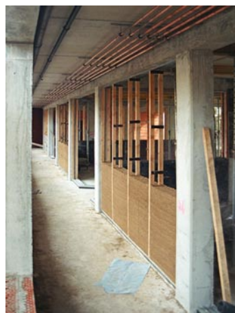
Ausführung der nichttragenden Wandteile aus Stampflehm. Die sogenannte »Kletterschalung« wird nach jeder neuen Schicht von eingestampftem Lehm hochgeschoben.
