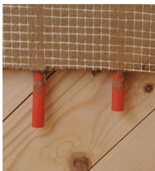
Aus den Wandheizungselementen heraustehende Rohrenden
