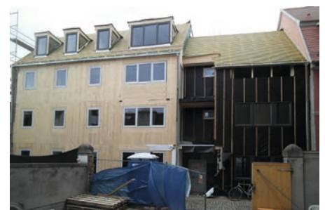
Das Dach und die Außenhülle konnten innerhalb kurzer Zeit winterfest gemacht werden
